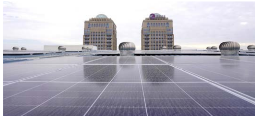
上海转运中心光伏发电设施
