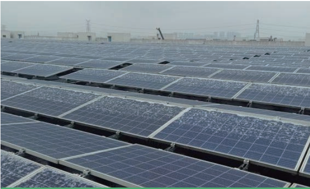
无锡基地光伏发电项目
