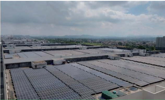
清远基地光伏发电项目
