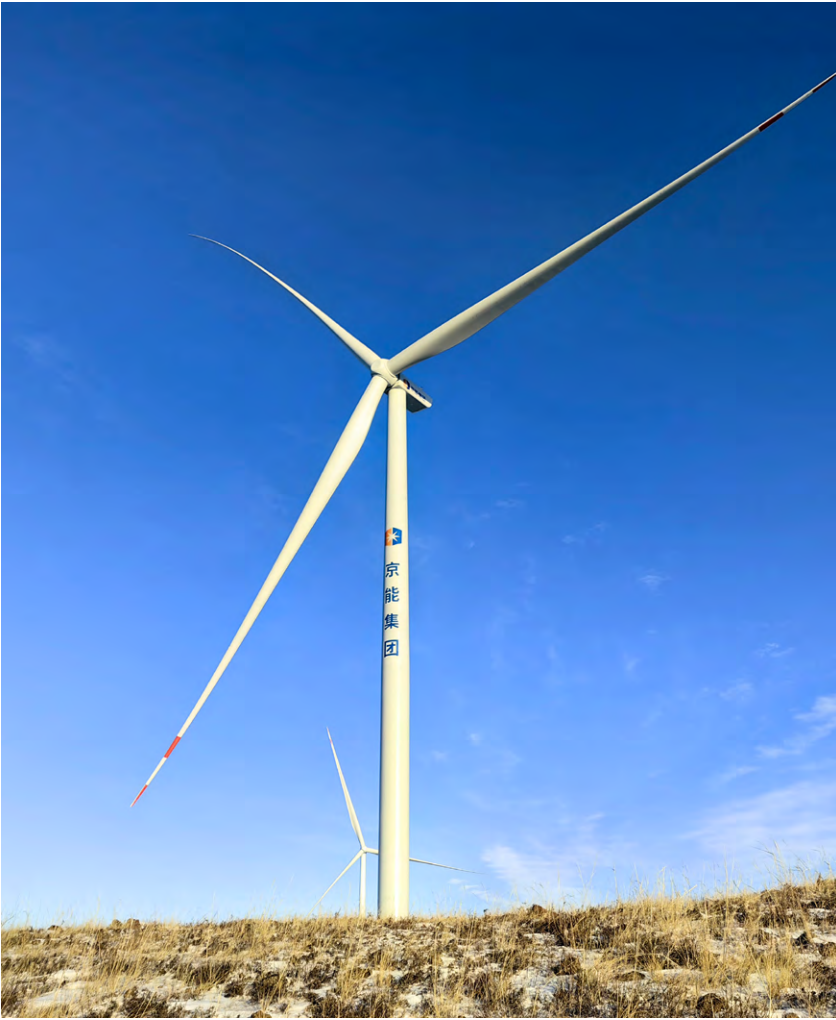
乌兰察布 150 万千瓦“风光火储氢一体化”大型风电光伏基地项目首台风机成功并网发电
