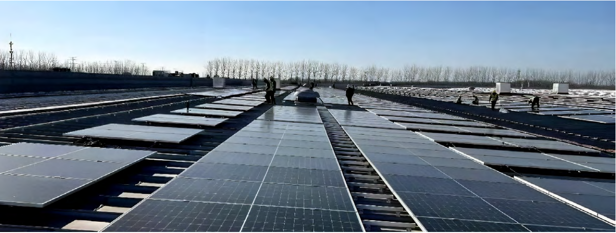
综合能源分公司开发建设的北汽动力总成 5.44MW 分布式光伏项目成功并网发电
