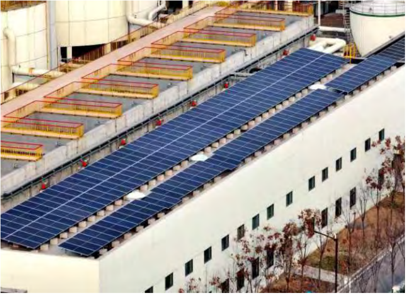
滑州热电 2.943MWp 屋顶分布式光伏项目全容量并网成功
