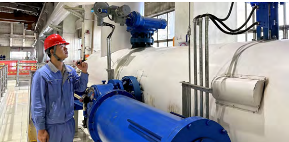
京泰发电对供汽管道阀门站、控制油站、供汽管路等设备情况进行全面检查
