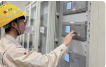
运维人员对发电设备开展隐患排查
