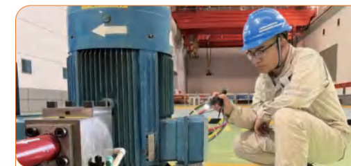
桂开公司巡检人员检查油压装置情况
