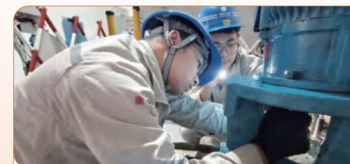
香电公司运维人员在检查排水泵
