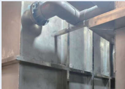
废水处理设施
