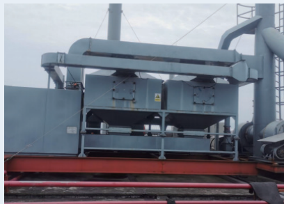
废气处理设施
