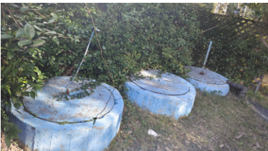
雨水收集利用
