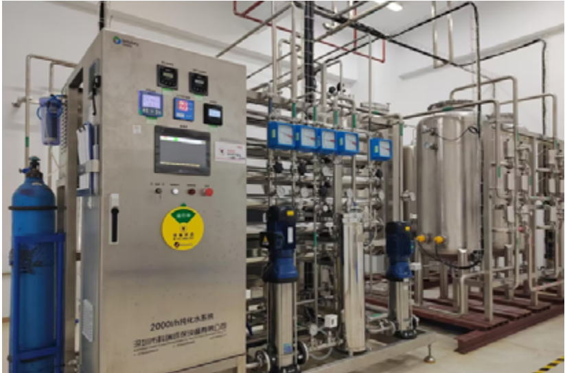
废水处理装置
