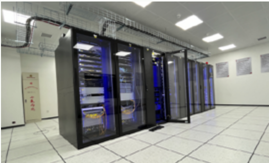
模块化结构机房
