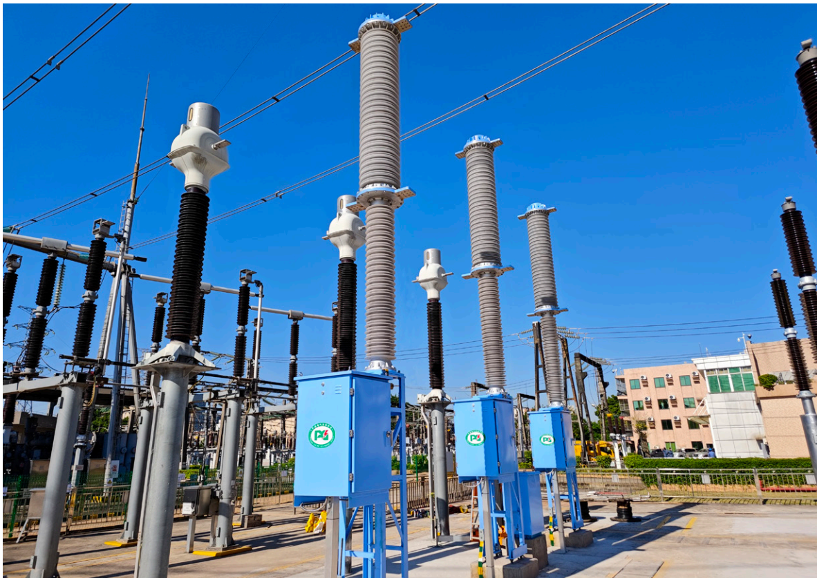
国际首台 252 千伏单断口真空断路器在广州芳村变电站成功挂网运行
