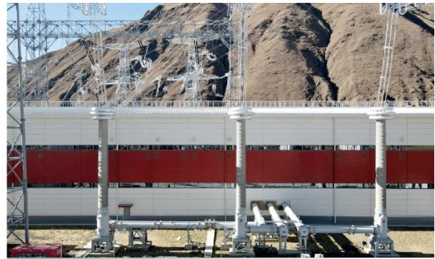
▲ 高海拔高地震烈度1100千伏GIS在川渝1000千伏特高压交流工程甘孜站投运
