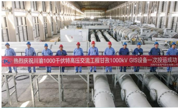
▲ 川渝1000千伏特高压交流工程甘孜站投运
