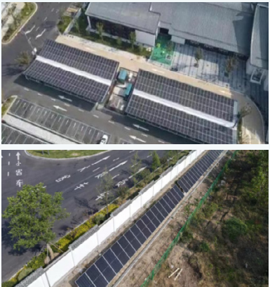
高速公路边坡和服务区车棚分布式光伏
