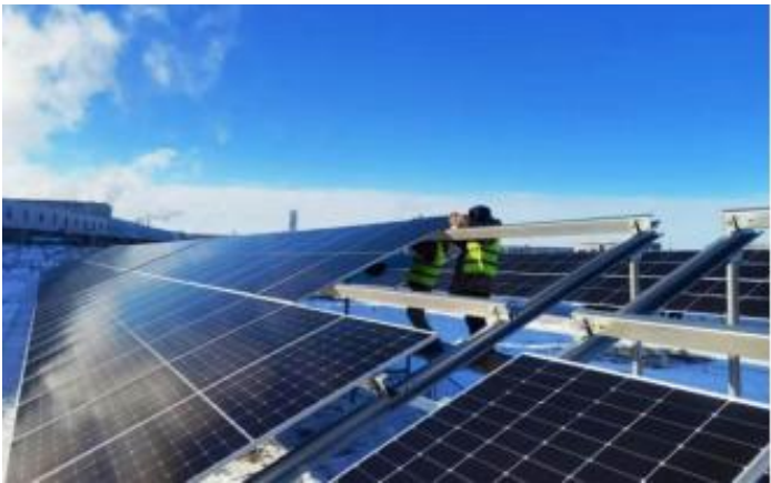
呼伦贝尔驰宏光伏发电项目
