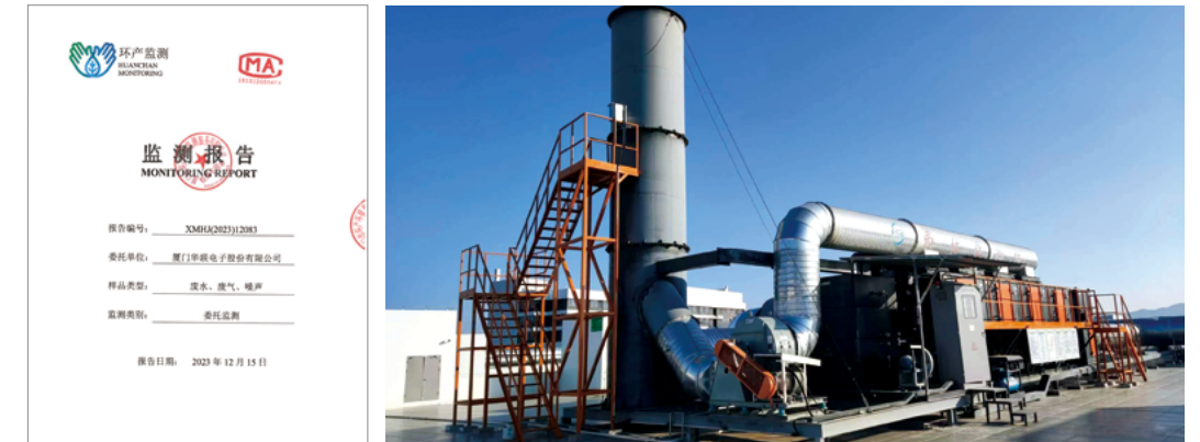
公司废气监测报告、公司废气处理系统
