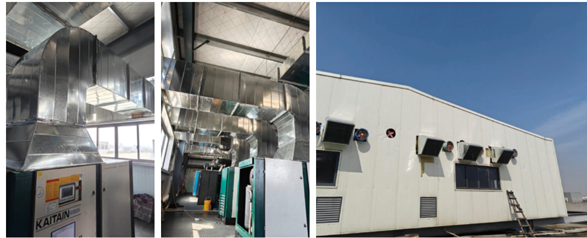
空压机热源外排
