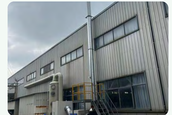
▲ 床垫生产车间新增废气处理装置
