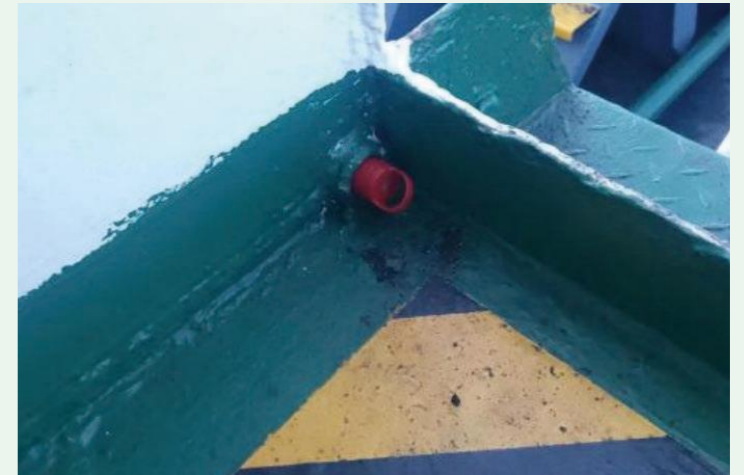
▲ “明州66”轮右舷重油舱透气管围栏木塞缺失整改后
