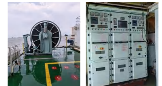
▲ “明州59”轮高压岸电设备
