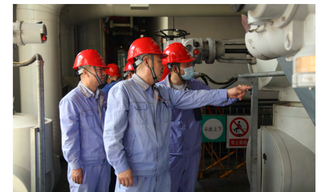
京秦热电加强设备巡视检查
