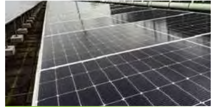
星科金朋新加坡厂太阳能光伏
