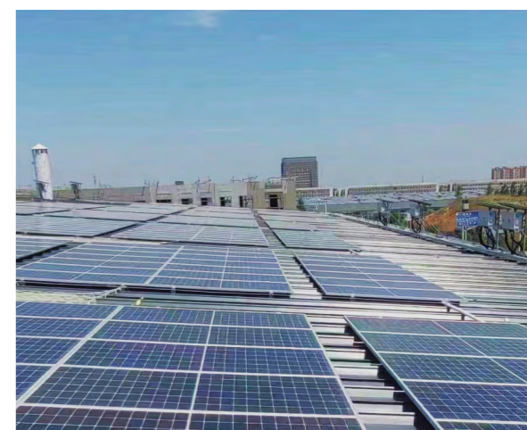
2023 年 7 月 18 日，唐山新能源沈阳铁西一期 15.48 兆瓦分布式光伏项目完成全容量并网发电
