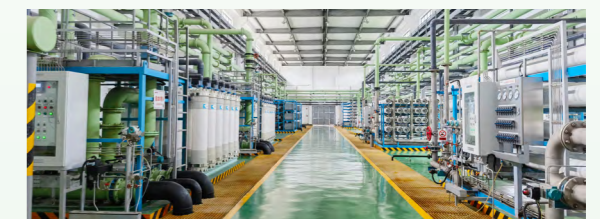
浙江公司南浔电厂化水车间
