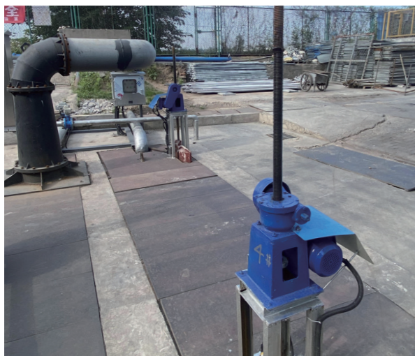
公司所属中铁宝桥扬州公司建立了雨水回收系统, 提高了水资源利用率。
