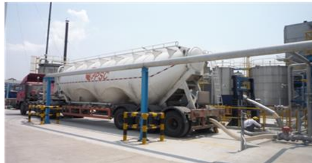
槽车卸料实景图
