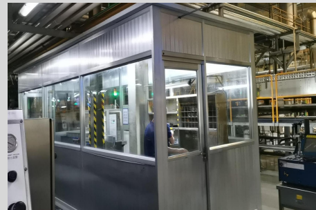
作业区域的空调房、隔音房
