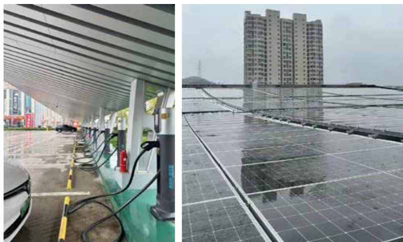
助力台州玉环商展中心屋顶分布式光伏及新能源汽车光储充放示范项目
