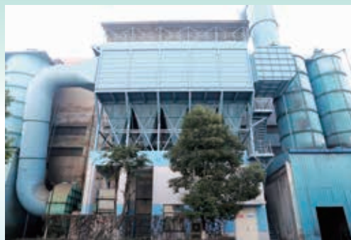
安徽海立整体除尘项目
