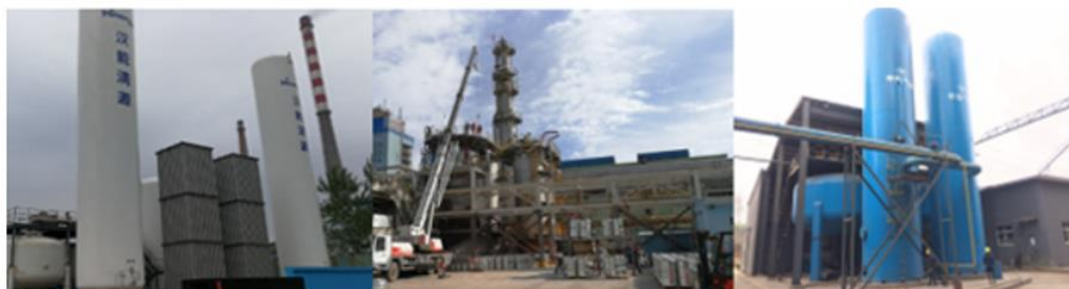
北京汉能清源 3200-93 变压吸附制氧装置
