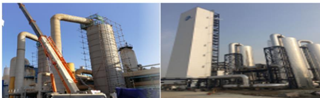
天安化工 5.2 万 Nm 3 /h 深冷空分装置
