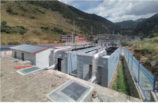
◎ 高原铁路项目（巴塘分部）600 立方米每小时一体化隧道废水处理设备正式运营
