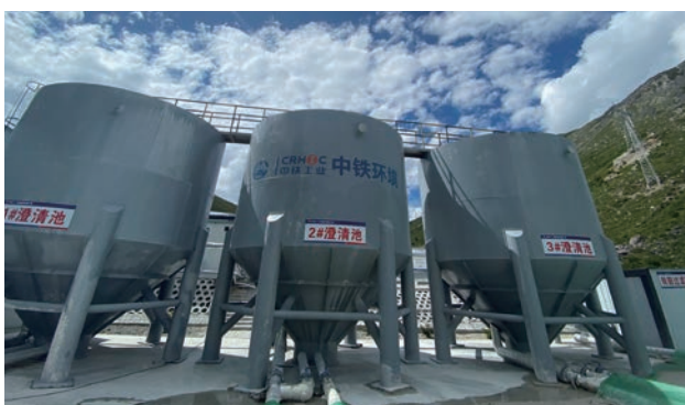
◎ 高原铁路污水处理项目
