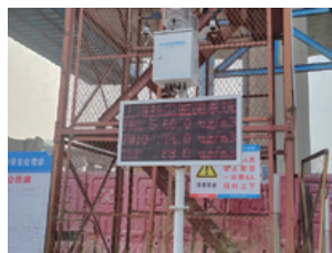
▶ 出入口100%安装 TSP在线监测设备
