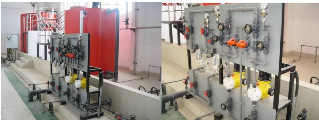
图 1-26 投加装置现场实体图
