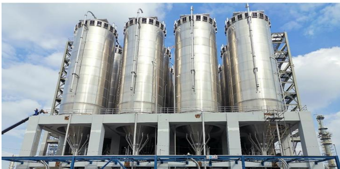
粒料掺混系统实景图
