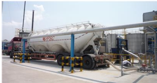
槽车卸料实景图
