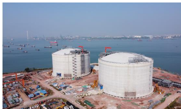
图 3：广州 LNG 应急调峰气源站
