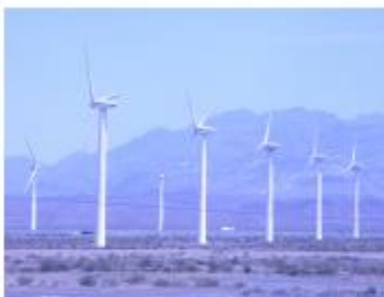
塔城发电（风力发电厂）
