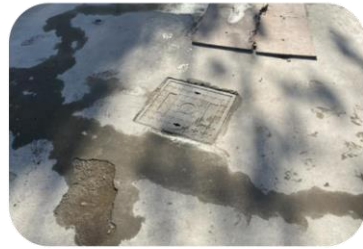
生活区雨水暗管
