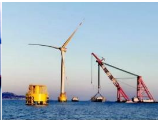
图 8. “亨通一航”号海上风电作业平台
