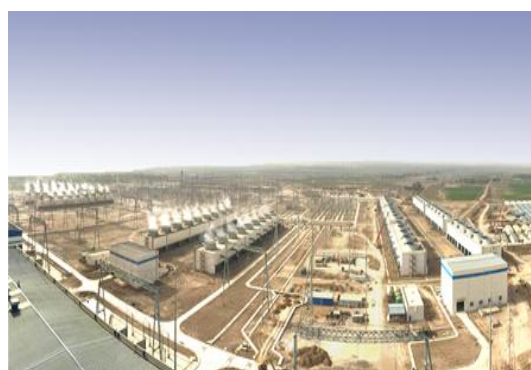
伊拉克华事德（WASSIT）电厂 36 台 NH-5100 和 30 台 NH-5360 型冷却塔
