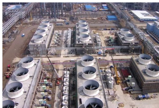
扬子石化-巴斯夫有限责任公司一体化石化项目(江苏·南京) 28 台 NH-4500 型冷却塔
