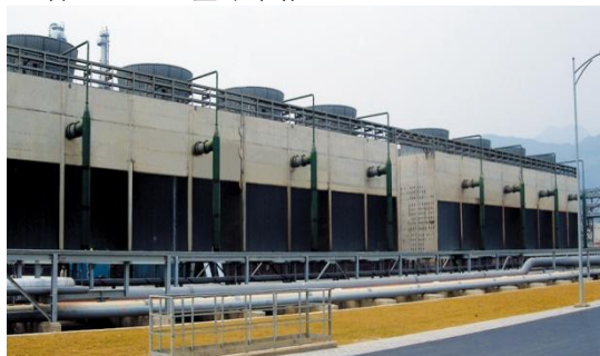
中海壳牌石油化工有限公司南海石化项目(广东·惠州) 40 台 NH-4500 型冷却塔
