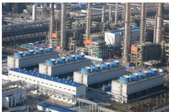
中国石油天然气股份有限公司独山子石化分公司(新疆·独山子) 25 台 NH-5000 型冷却塔
