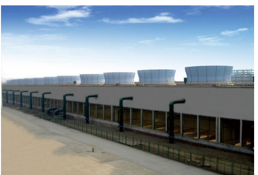
中国石油天然气股份有限公司兰州石化分公司 （甘肃·兰州）13 台 NH-5000 型冷却塔
