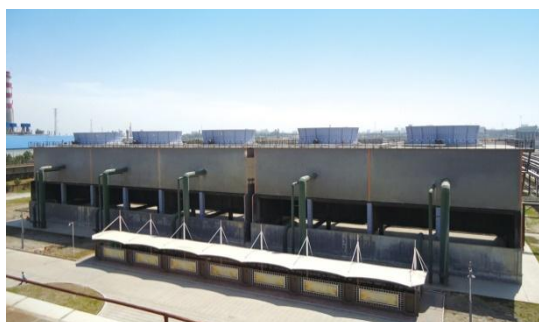
陕西咸阳化学工业有限公司(陕西·咸阳) 12 台 NH-4500 型冷却塔
