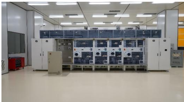
(B200 槽式设备实物图)
