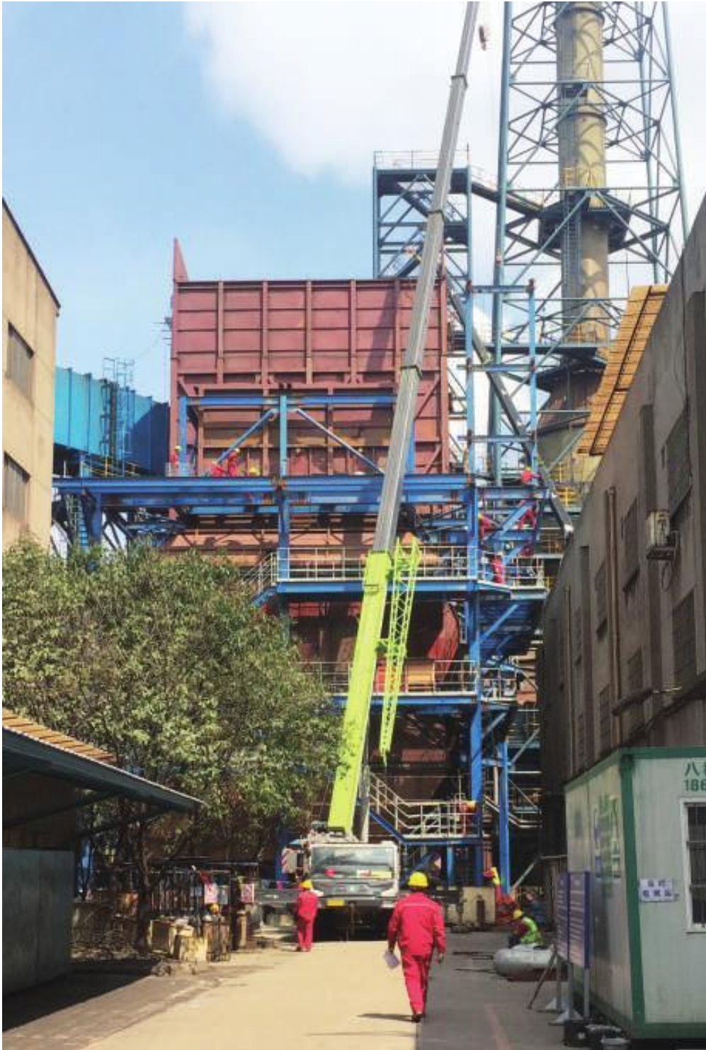
2019年3月，柳钢重点环保技改项目——110m 2 烧结烟气 SCR 脱硝技术项目经过3个多月的紧张建设后进入最后安装冲刺阶段。该项目采用的是选择性催化还原脱硝技术，先脱硝后脱硫方案。投产后能大幅度降低烧结烟气中氮氧化物的排放量，极大地保护大气环境，创造良好的环保效益和社会效益。图为现场施工人员正在吊装GGH反应器壁板。
