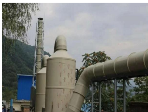
选矿厂药库废气处理系统
