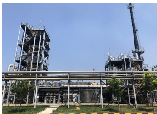
化学分公司离子液氨气综合回收
