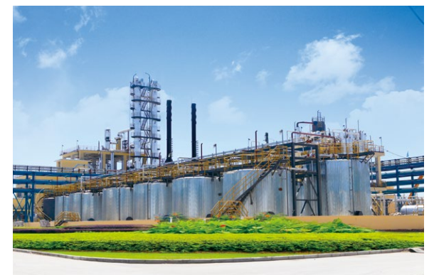
苯加氢罐区 VOC 治理装置
