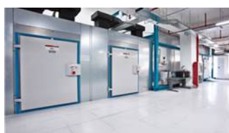
EMC实验室（外部）
