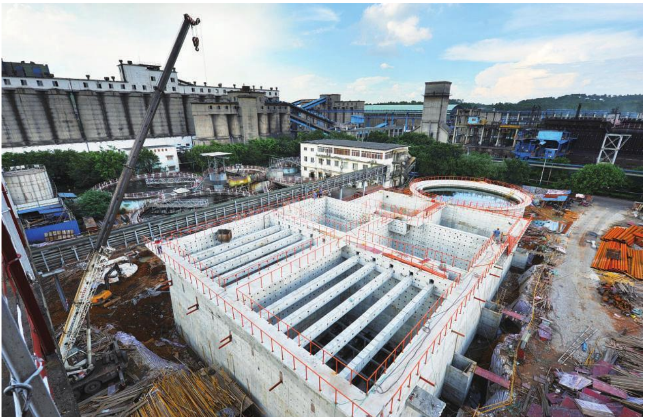
柳钢焦化废水生化处理系统升级改造项目主体工程完成土建施工部分。工程交付投用后将有效缓解柳钢环保压力，也有利于废水循环回收利用，环保效益和经济效益明显。
