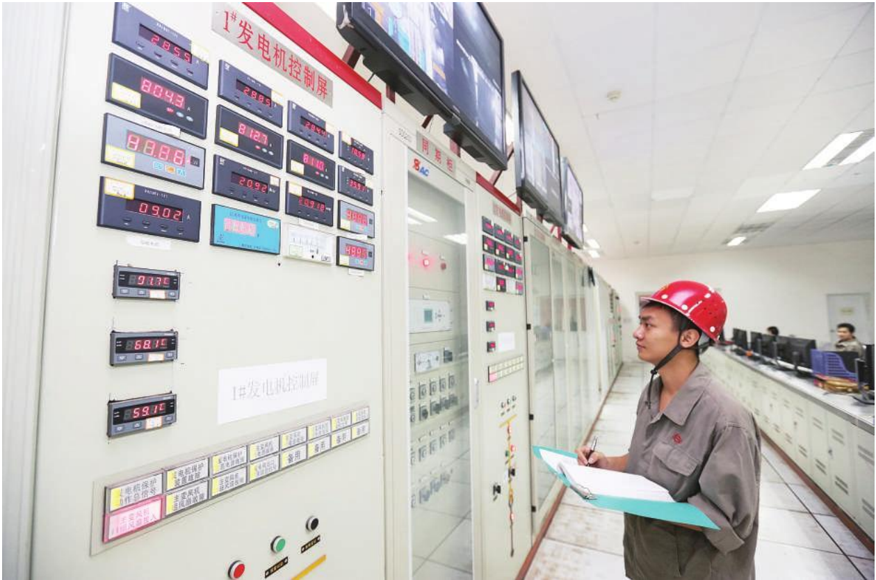
图为点检人员检查相关电气设备运行情况。
