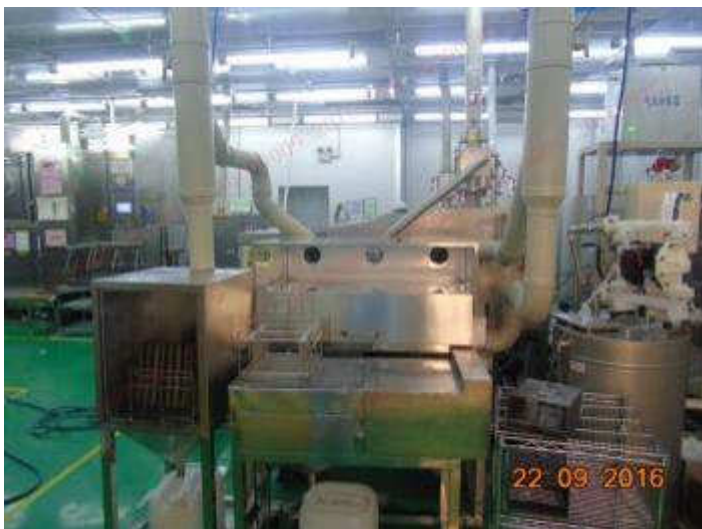
加装排风系统后之雷冈清洗机（金桥厂）
