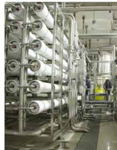
青啤二厂水处理中心
