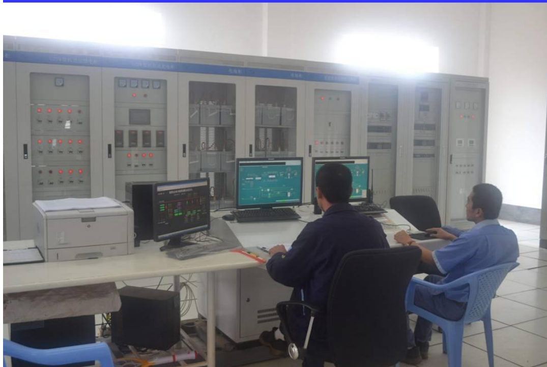
发电控制仪表室
