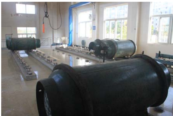
图 8-7 现状加氯间氯库
