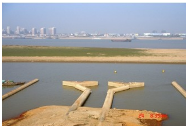
青云水厂取水头部露出水面
