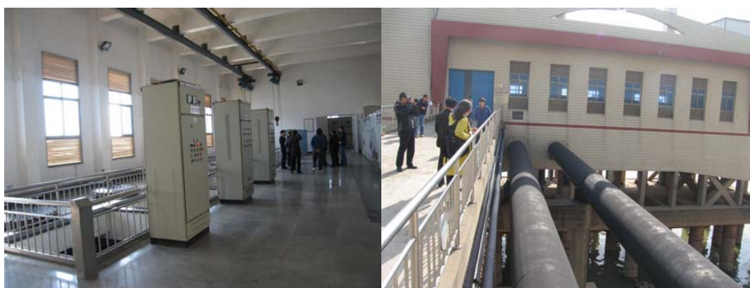
图 5-1 牛行水厂取水泵房
