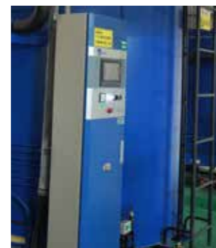
▲ 三水公司天然气锅炉
