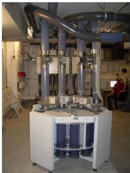
医疗气动物流系统—转换中心
