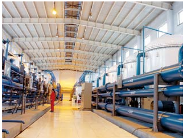
辽河油田稠油污水处理站
