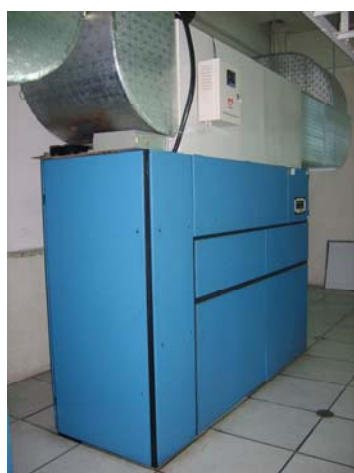
机房专用空调上安装热交换节能器—室内
