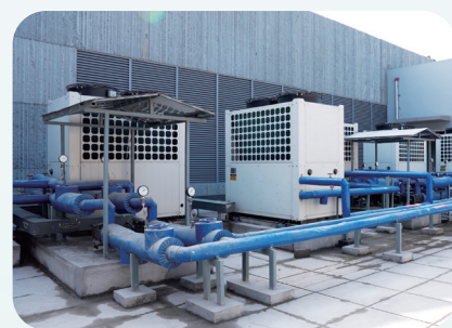
宁波甬能综合能源服务有限公司综合能源项目
