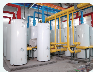
宁波甬能综合能源服务有限公司综合能源项目
