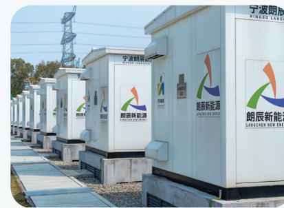
余姚电网侧储能项目
